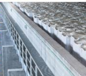
Le traitement du sodium avec l'installation TNA
